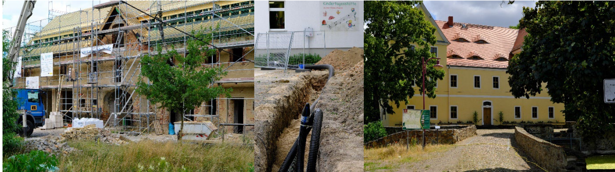
Abbildung 13: Das Nahwärmenetz in Röcknitz bindet in einem ersten Bauabschnitt eine Vielzahl öffentlicher Gebäude ein (Fotos: Frank Wagener).
